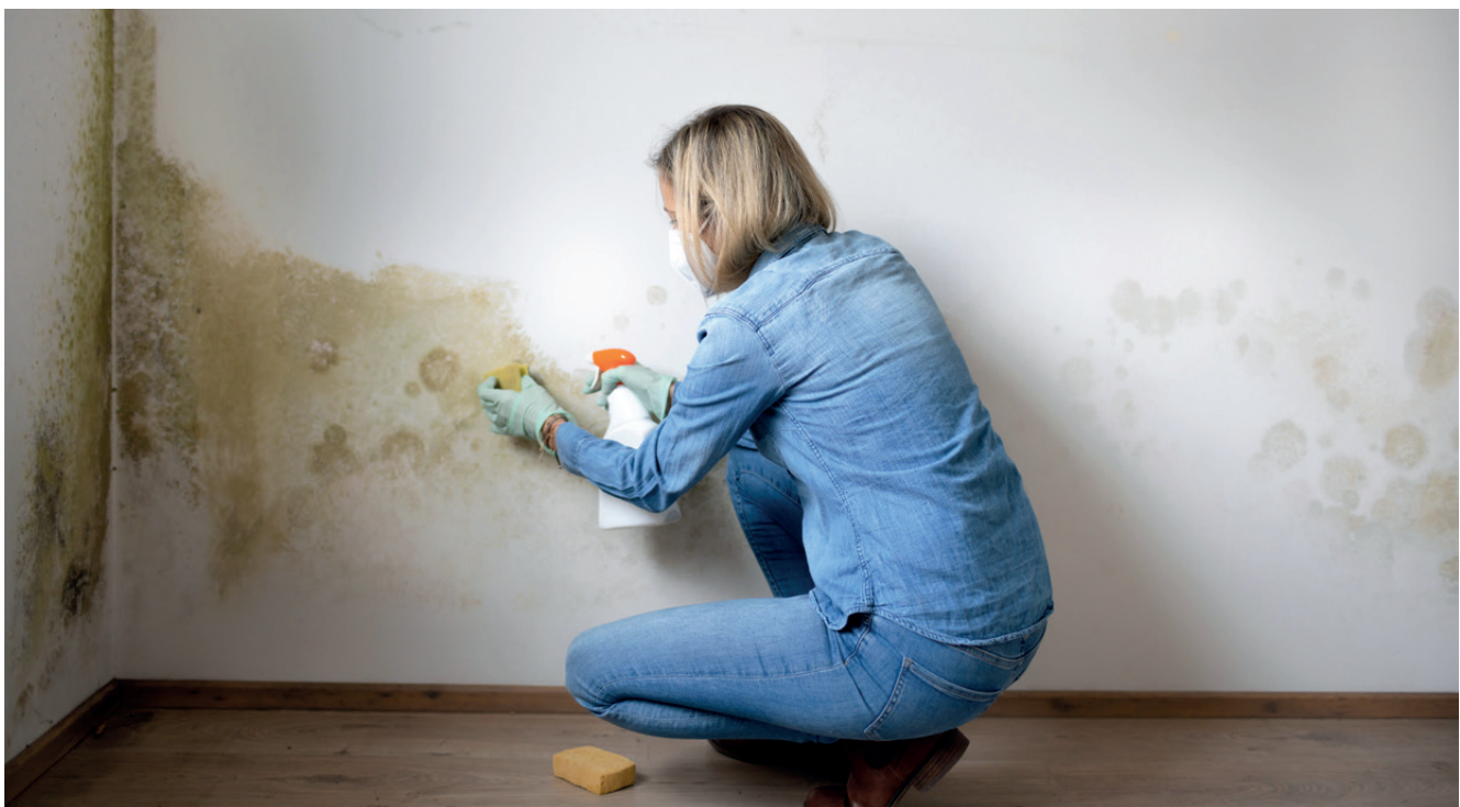
Richtiges Heizen und Lüften verhindert Schimmelbildung und spart jede Menge Energie.
