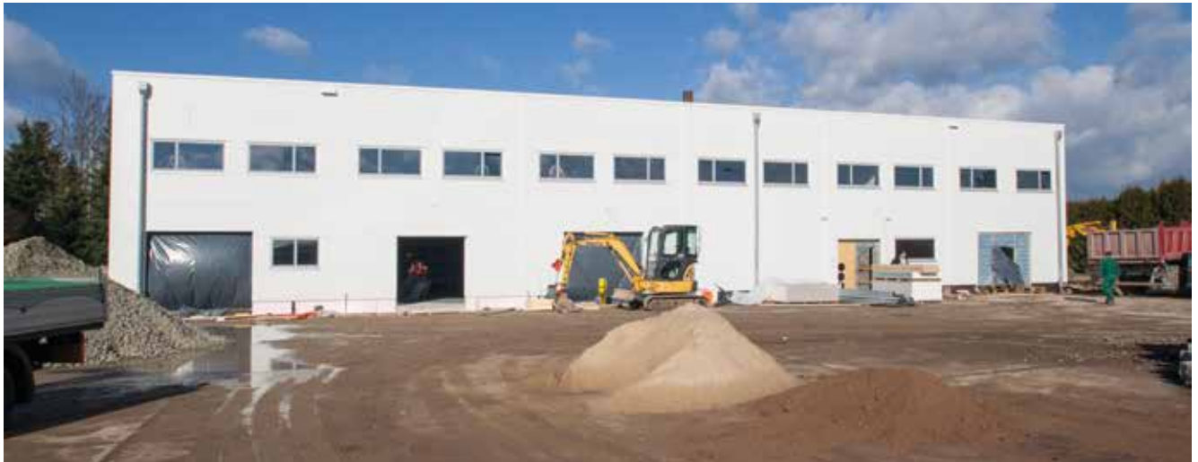
Die Gebäudehülle auf dem Gelände des neuen Betriebshofes steht schon. Der Innenausbau erfolgt bis Juni 2015.
